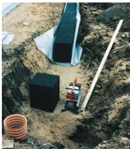
Podłużna studnia chłonna w dzielnicy przemysłowej
